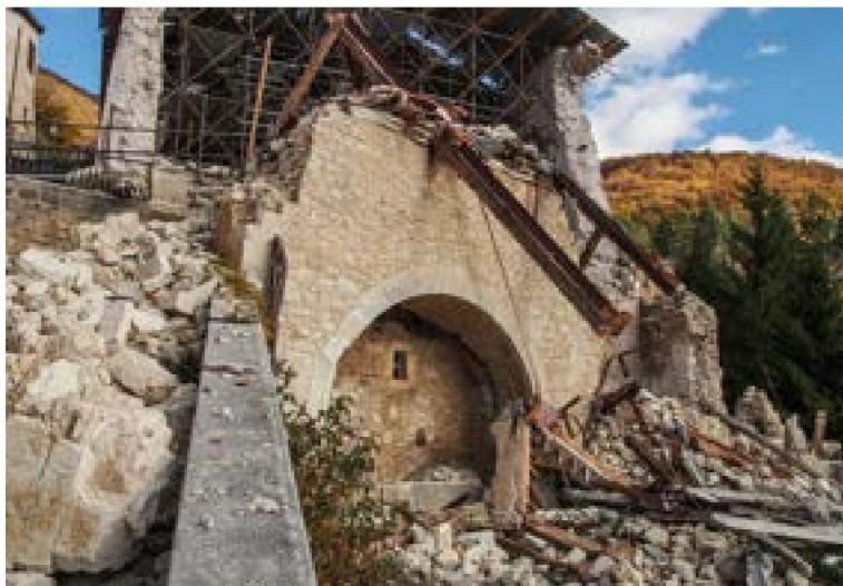
سازه بدون قاب آسیب دیده در اثر زلزله، ایتالیا، ۲۰۱۷. عکس: ایسوک نیشیکاوا.
