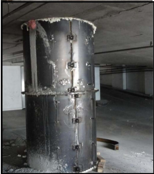
ستون‌های آسیب‌دیده با پوشش تکمیل‌شده
